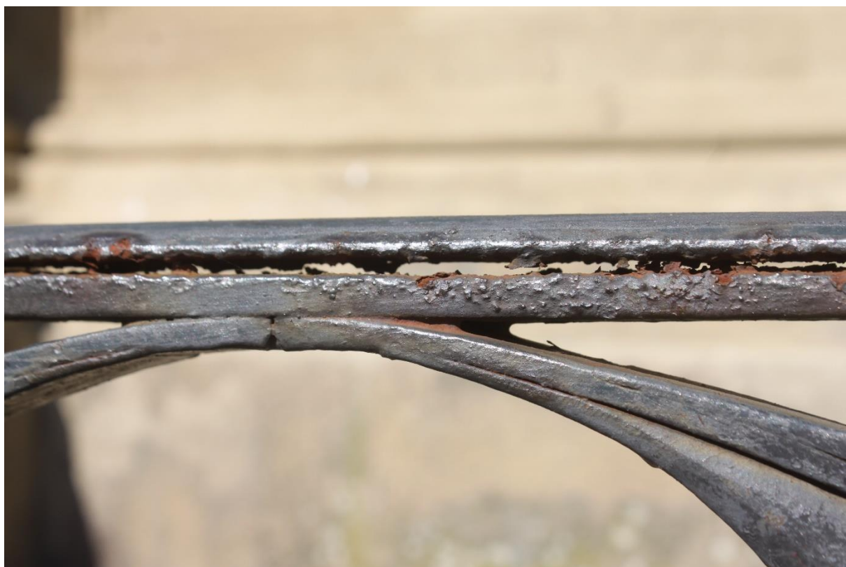
Oplocení Koroze mezi vrstvami horní lišty- madla
