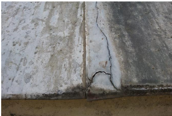
Trhlina na pohl.levé straně
