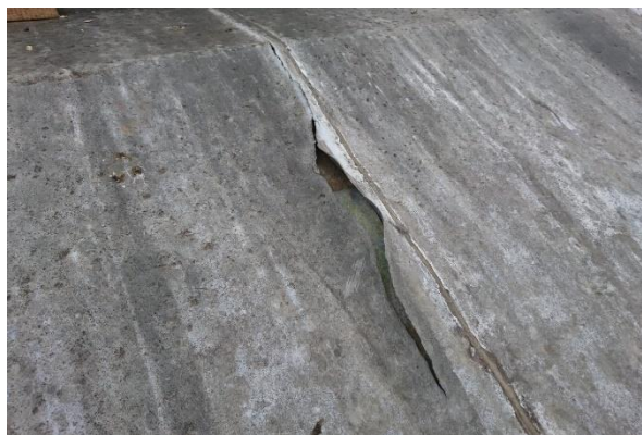
Trhlina v zadní části
