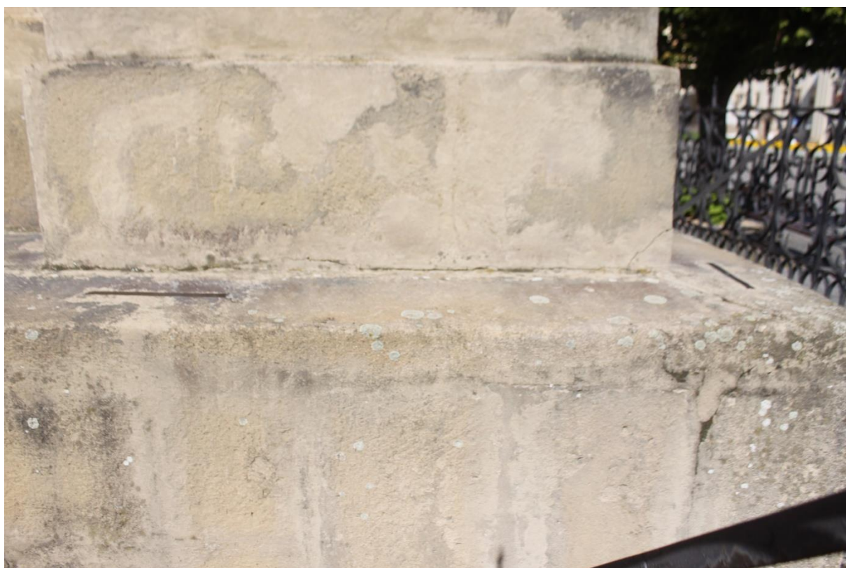
Podnož Patrné znečištění atmosférickým spadem a koloniemi náletových kultur
