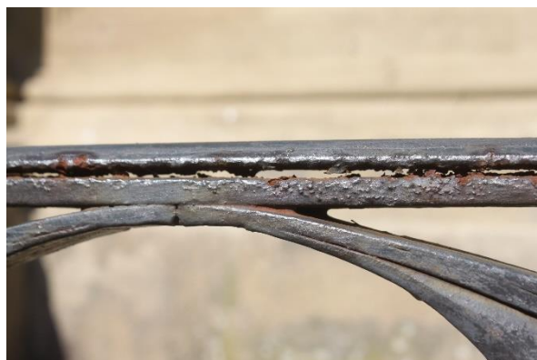
Koroze mezi dvěma vrstvami lišty
