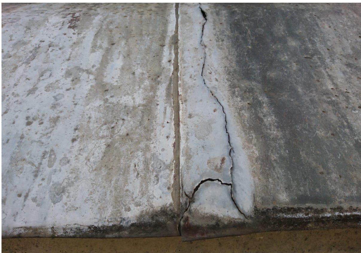
Trhlina a nefunkční oplechování na pohledově levé straně
