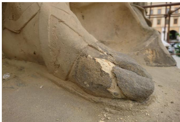
Socha sv. Floriána- hmota kamene poškozená pod vrstvou materiálu doplňku
