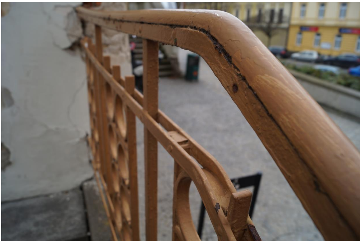
Dtto, detail madla zábradlí s poškozením a výraznou destrukcí, způsobující zatékání vody a vznik rzi – pohled na vodorovnou horní část
