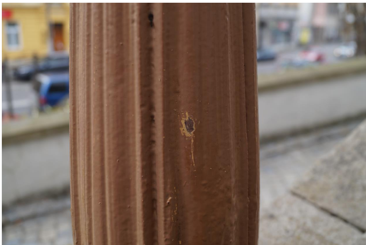
Detail provedené sondy na litinovém sloupu (sytě hnědá, spodní část rez...)
