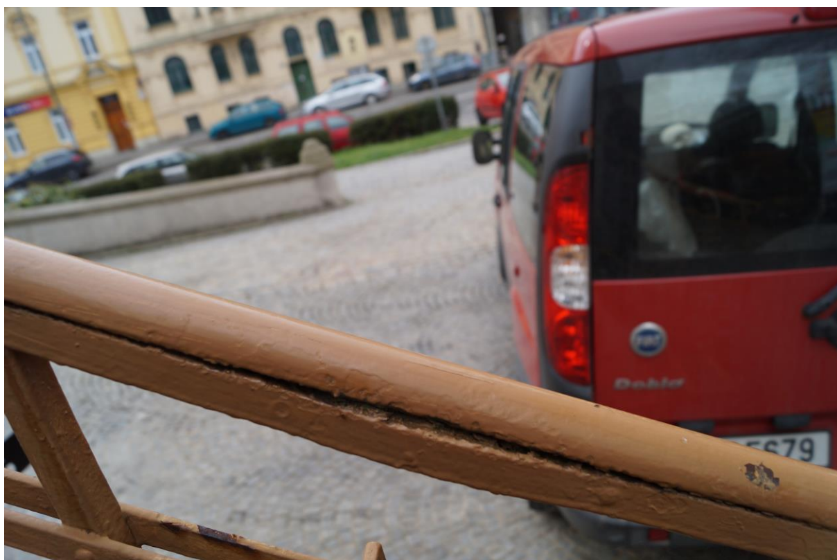
Detail madla zábradlí s poškozením a výraznou destrukcí, způsobující zatékání vody a vznik rzi
