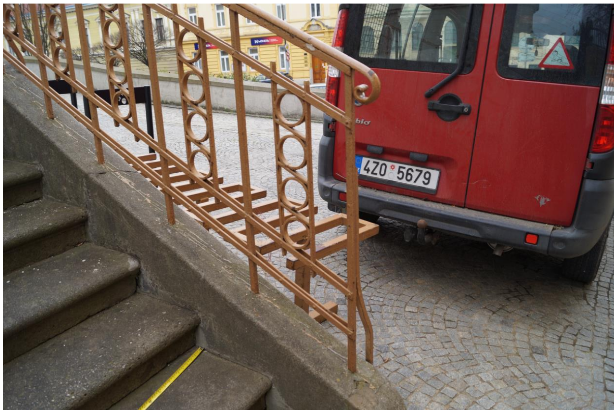
Celkový pohled na stav zábradlí a trnože, do kterého je konstrukce uchycena
