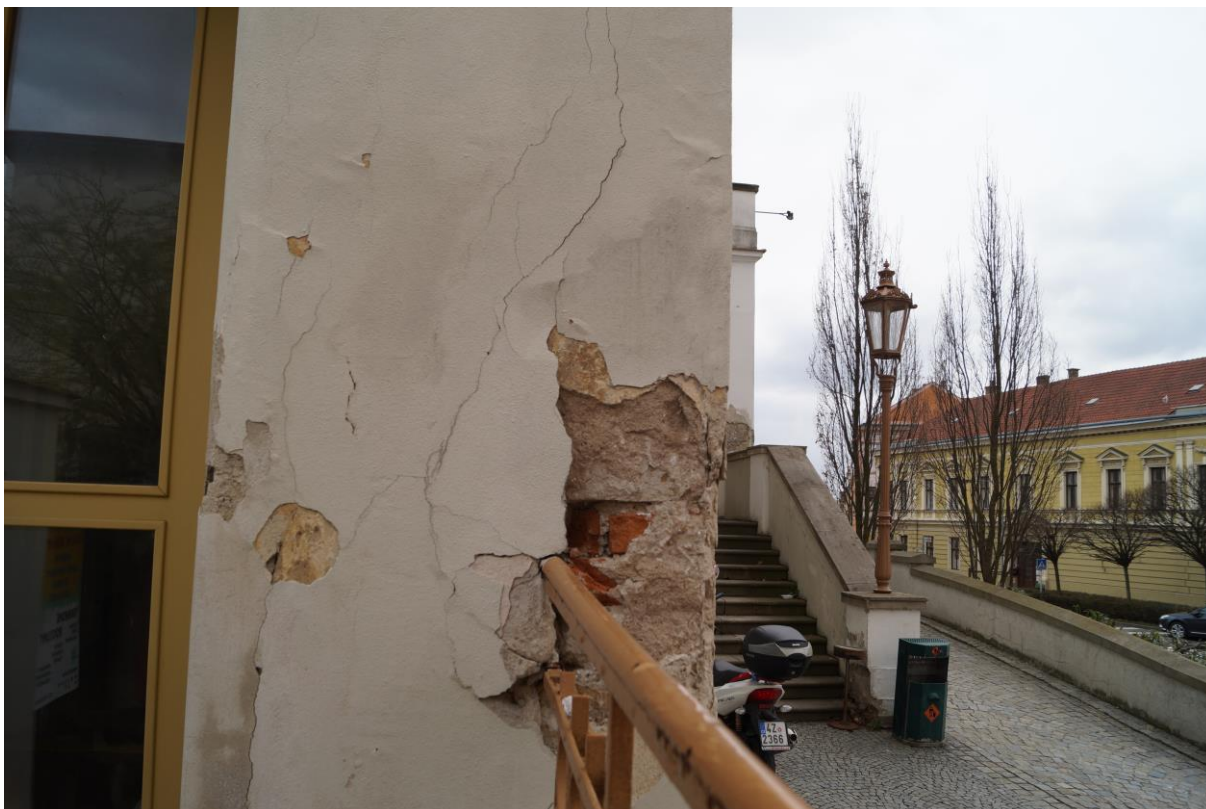
Detail uchycení madla zábradlí s poškozením zdiva a výraznou destrukcí, způsobující zatékání vody
