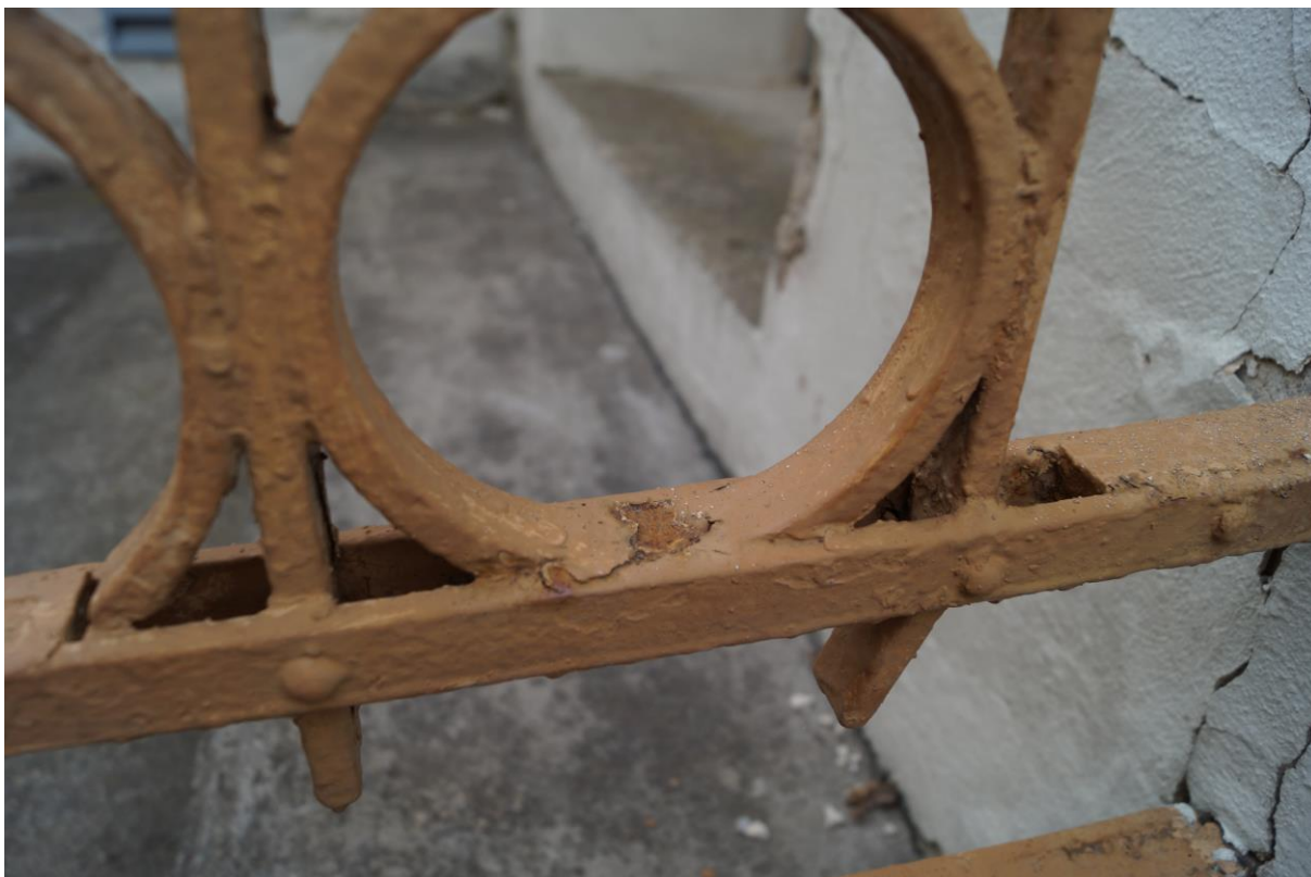
Detail sondy provedené na spodní části zábradlí se silným stupněm rezivění, silný nános nepůvodního hnědého nátěru zábradlí
