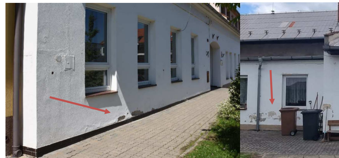
Vlhkostní poruchy zdiva v exteriéru
