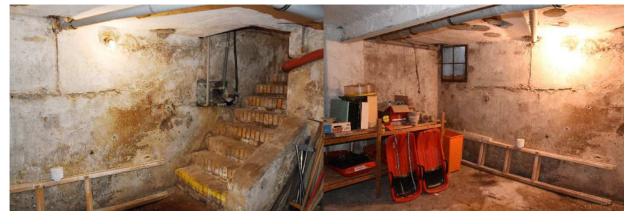
Vlhkostní poruchy a poruchy statiky ve sklepě
