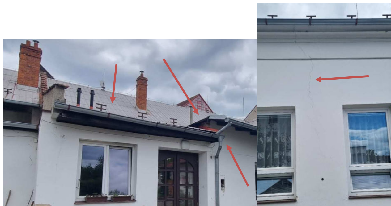
Složité detaily, krytina na hranici životnosti, statické poruchy fasád
