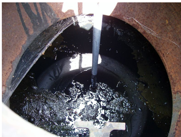
Obr. 4: Obsah nádrže č. 2
