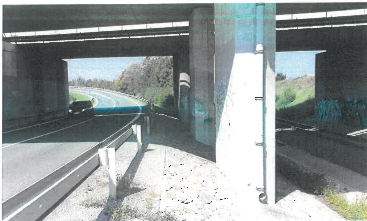
Obrázek 8 – Sil. II/367, podjezd pod mostem na D1, prostor mezi svodidlem a mostními pilíři
